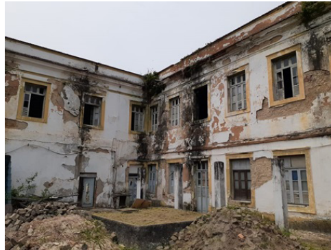
Figura 10 Entulho em local inadequado
